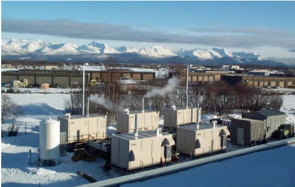
Fem 200kW brenselceller i Alaska med naturgass som drivstoff http://www.nrel.gov/hydrogen/photos.html
